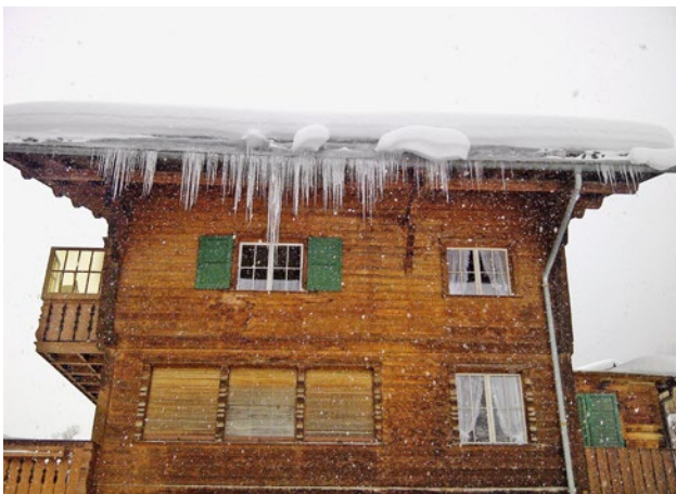
Bild 15: Eiszapfen aufgrund von Rückschwellwasser
