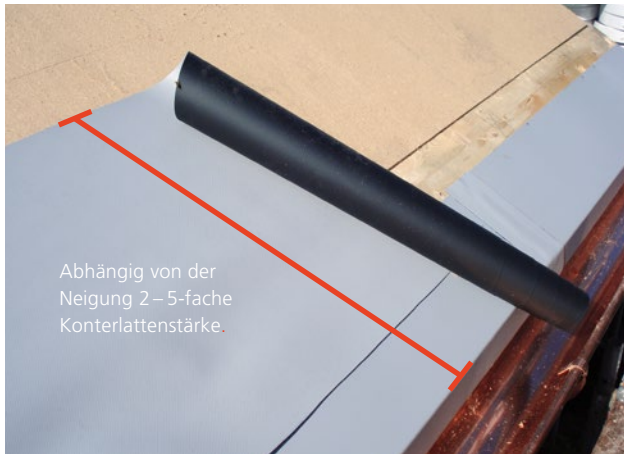
Bild 14: UV-beständige Folie im gefährdeten Bereich
