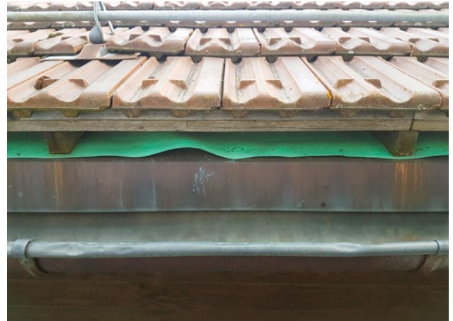
Bild 17: Ungenügend geschützte Unterdachbahn
